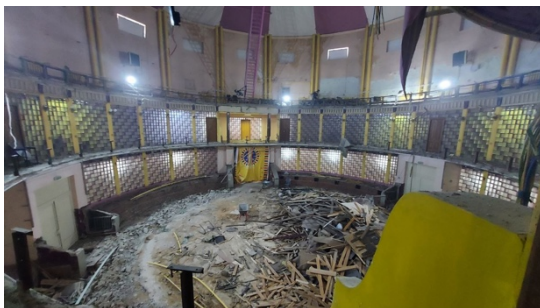
Фото №2. Разрушенный манеж ГУЦЭИ
